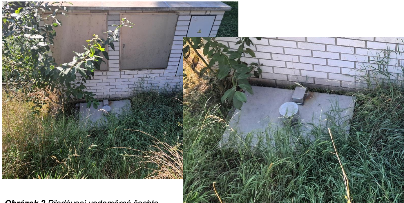
Obrázek 2 Předávací vodoměrná šachta
